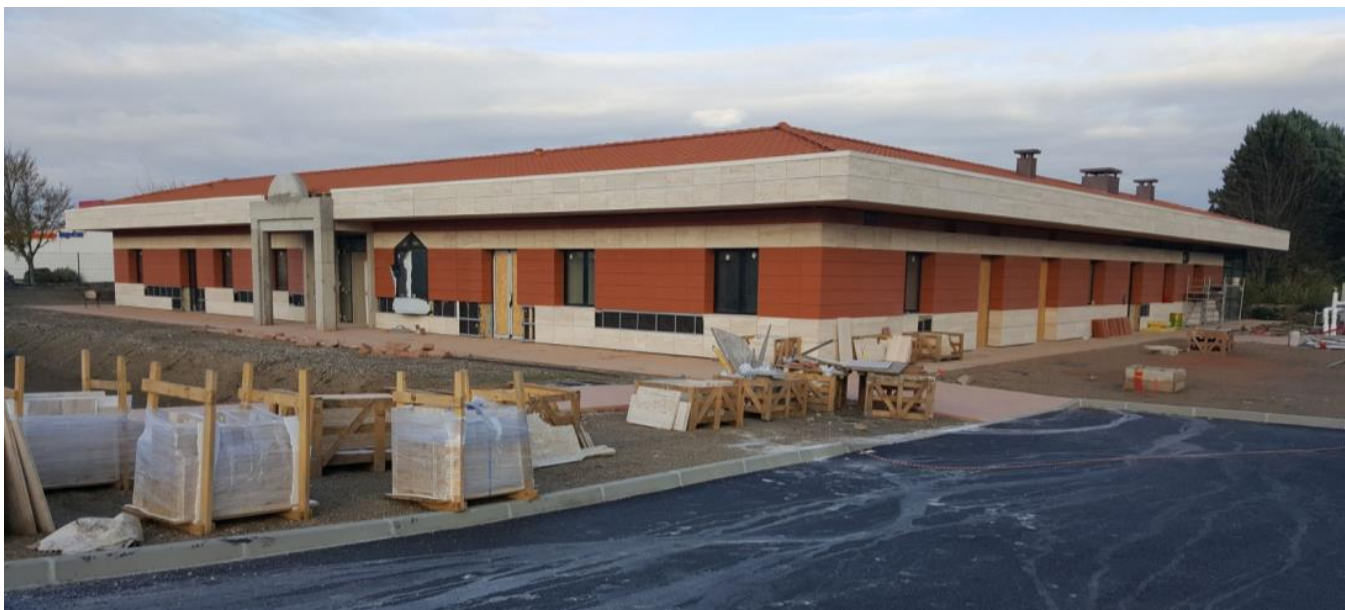
Vista delle facciate sud-est e dei lavori di sistemazione degli spazi intorno all'edificio
